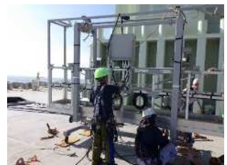
動力ケーブル外観確認
