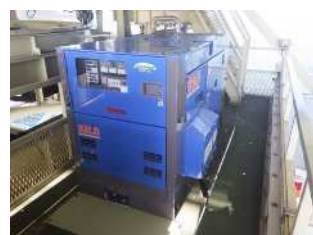
更新後（発電機）
